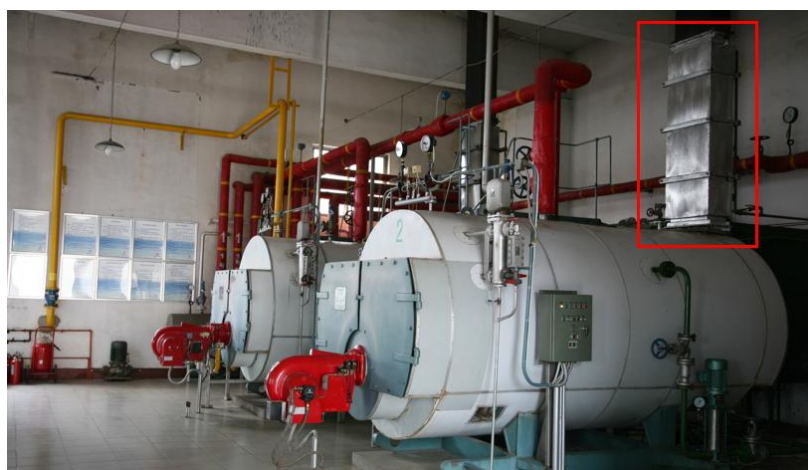
图 79 蓝天宾馆的锅炉烟道节能回收装置图
